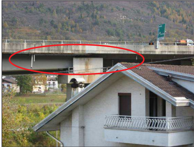
Foto 7: attuale impianto di smaltimento delle acque meteoriche nel viadotto Ponte nelle Alpi al km 78+300 circa.
